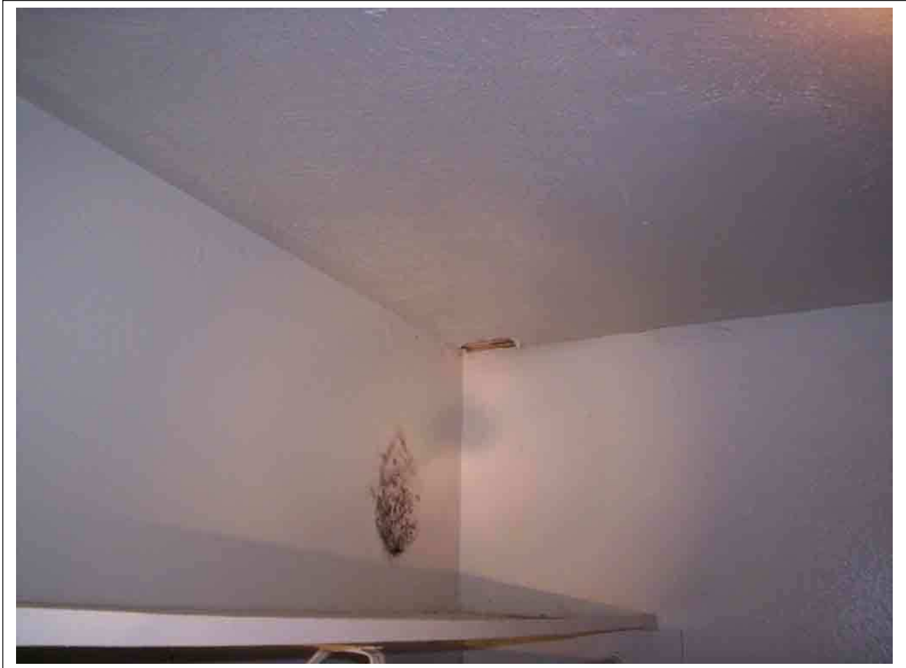
29. Comments: unit 109- moisture intrusion / fungus H&S
